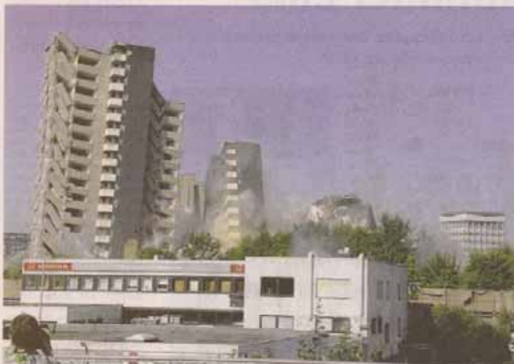
Der nördliche Teil bricht in sich zusammen...
