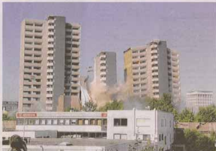
... doch das Treppenhaus bleibt (gegen die Planung) kurz stehen. Foto: WAZ, Jürgen Metzendorf
